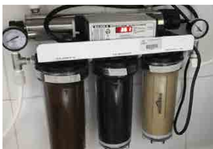
Figura 46. Estado de filtro esterilizador UV, fecha: 19/02/2019.
