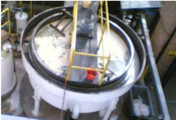
Figura 8.2. DAF de la PTAR de una industria de productos lácteos.
